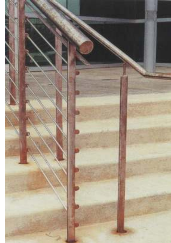
1.4301, rauhe Oberfläche, schlechte Form, Salzstreuung, Rost entfern- bar, tritt immer wieder auf
